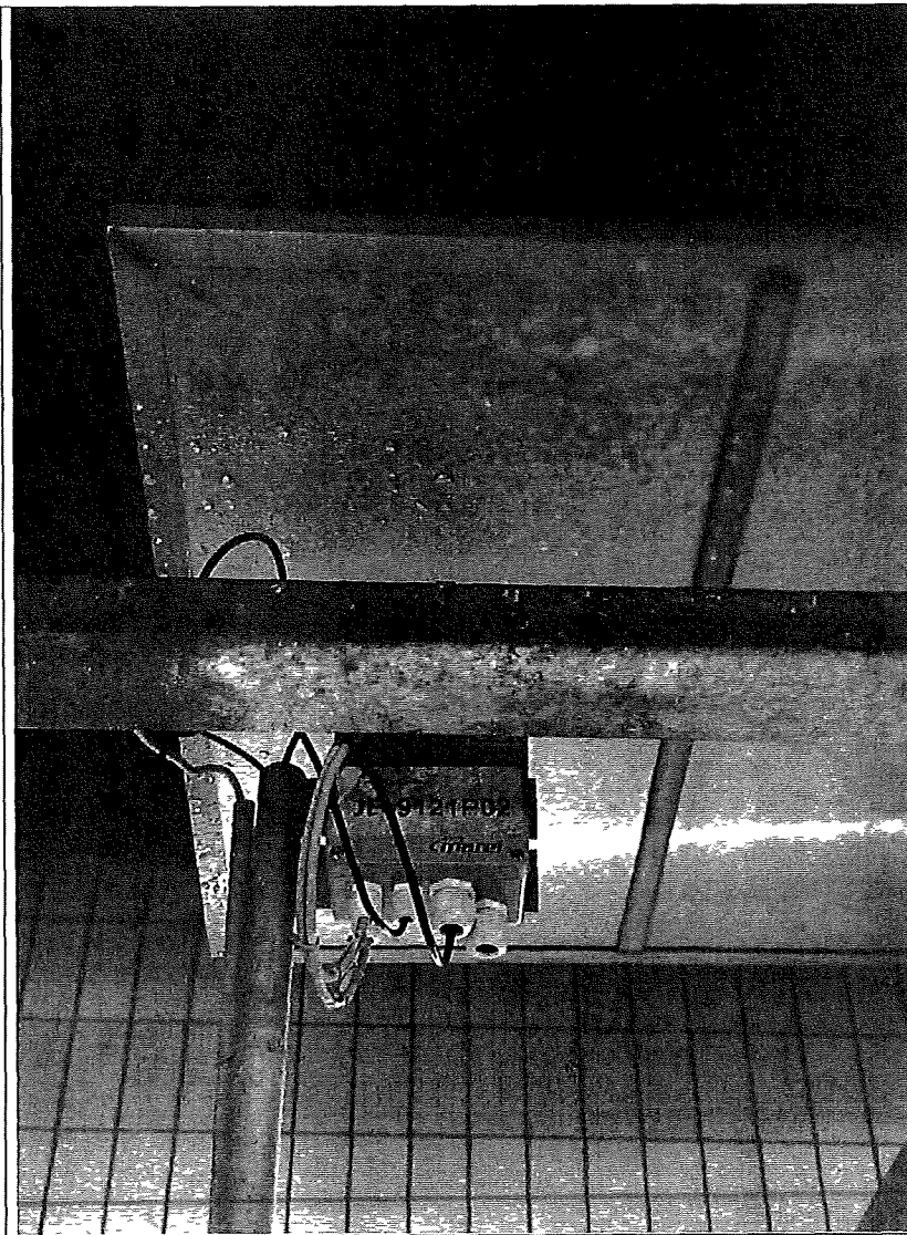
3. Condens op de metal plaat boven de keurbordes
